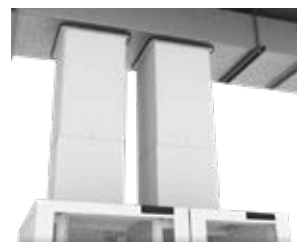
Verticaal luchtkanaal (Vertical Exhaust Duct)
