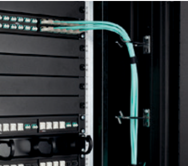
Verticaal in het 19-inch vlak
