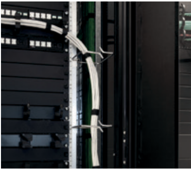
Verticaal in het 19-inch vlak
