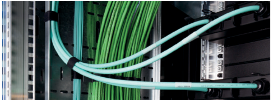
Verticaal in het rack
